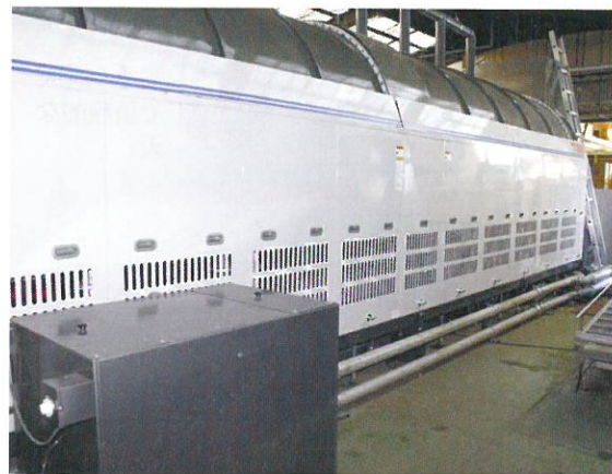
加古川工場に導入されている最新の洗浄設備
